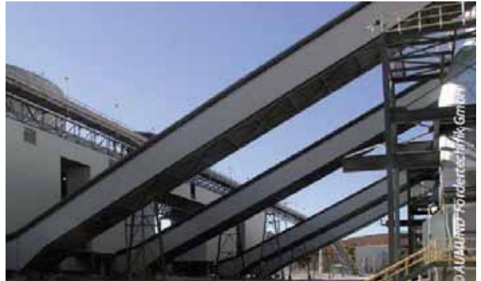
アメリカの Holcim 社セント・ジュネビーブ工場で貯蔵サイロからクリンカーを引き出す 4 台の AUMUND KZB 型パンコンベアー、4 台の独立した垂直型ミールへ搬送
